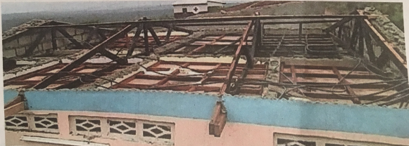
Das Dach des Schul- und Bildungszentrums wurde vom Sturm weggerissen.
